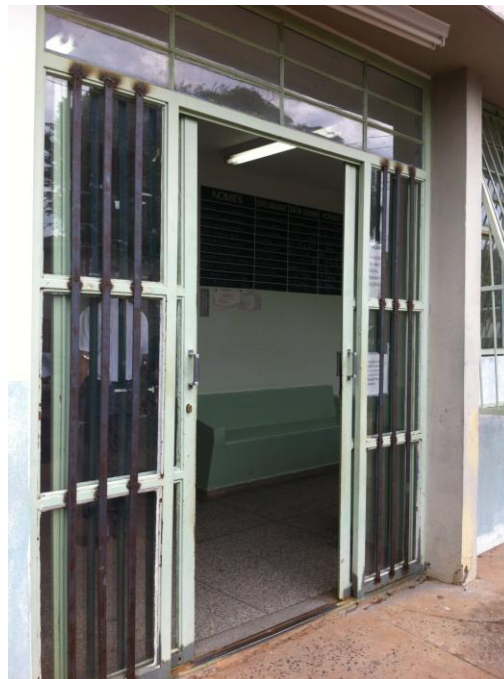
Figura 15 – Alteração da porta de entrada para 02 folhas, mantendo a bandeira fixa. Fonte: Secretaria do Planejamento de Bauru
