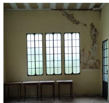
Figura 13. Trincas e descascamento da tinta da alvenaria (acervo pessoal)
