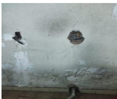
Figura 8. Bolor da alvenaria (acervo pessoal)
