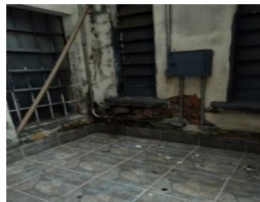
Figura 7. Degradação da estrutura lateral (acervo pessoal)
