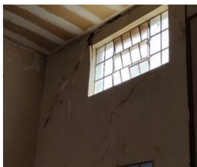
Figura 12. Trinca possivelmente causada pela falta de verga e contra-verga (acervo pessoal)
