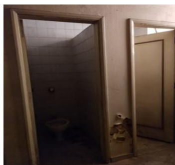
Figura 11. Descascamento da tinta da alvenaria (acervo pessoal)
