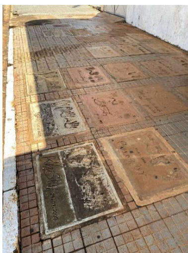
Figura 6. Calçada sem manutenção. (Acervo pessoal 2023)
