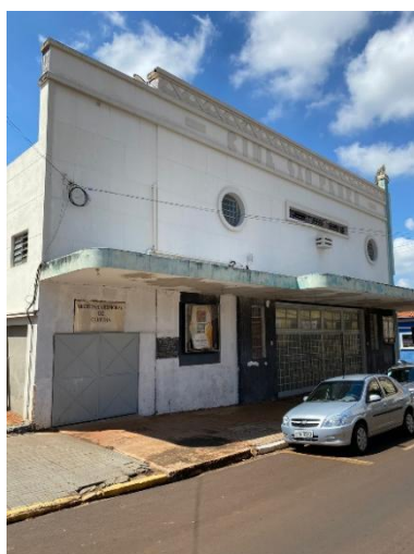
Figura 5. Fachada principal com infiltração e sem manutenção. (Acervo pessoal 2023)
