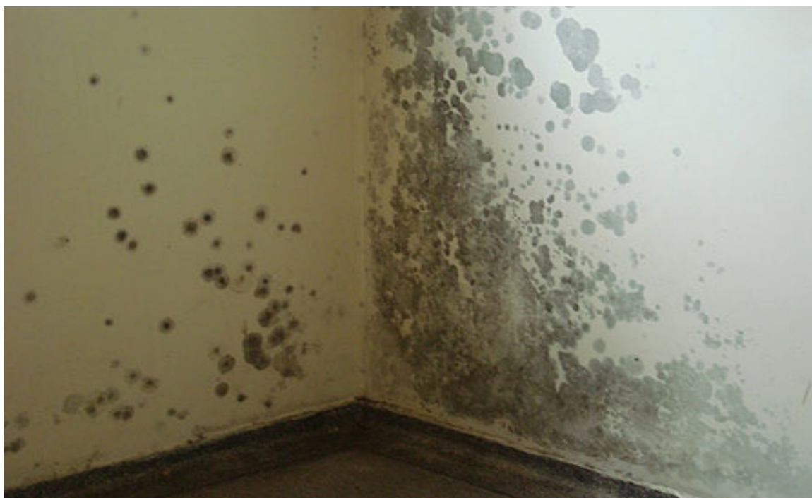
Figura 4 - Umidade em paredes 2
