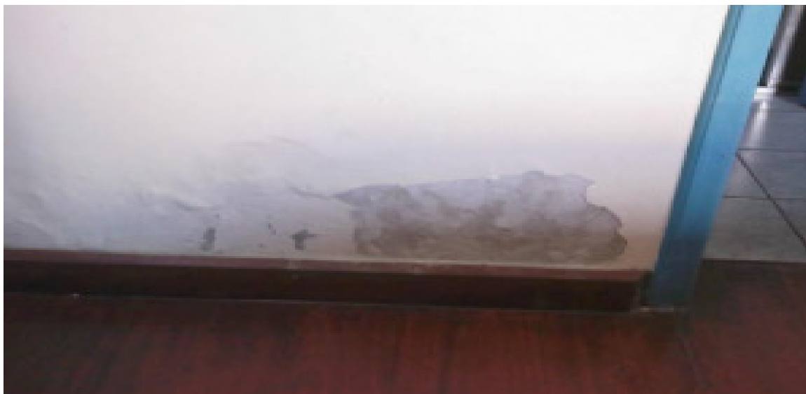
Figura 3 - Umidade em paredes
