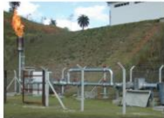
Sistema de coleta e queima de gás
