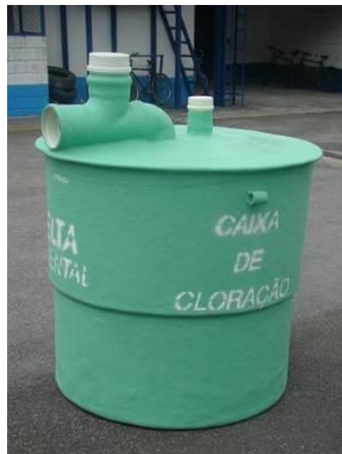
Figura 29: Exemplo de sistema desinfecção ETE Compacta.
